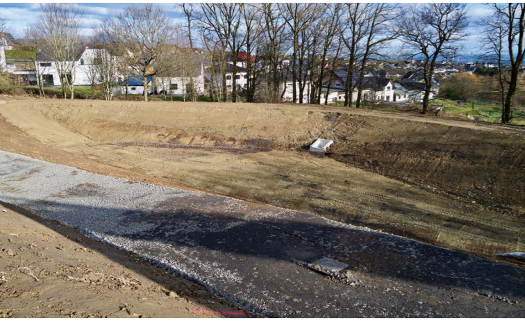
Wasser kann in Wasserrückhaltebecken gesammelt werden und von hier abgeleitet oder anderweitig verwendet werden.
