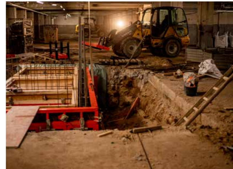
Während an dem einen Kellerende noch die letzten Abbrucharbeiten stattfinden, wird auf der anderen Seite ein Fahrstuhlschacht vorbereitet.
